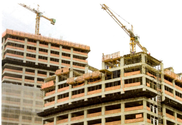
Emprego de fôrmas tipo mesa voadora e concretagem com mastros fixos à estrutura do edifício garantiram um ciclo de execução de sete dias por laje para a torre Golden e nove dias para a torre Diamond
